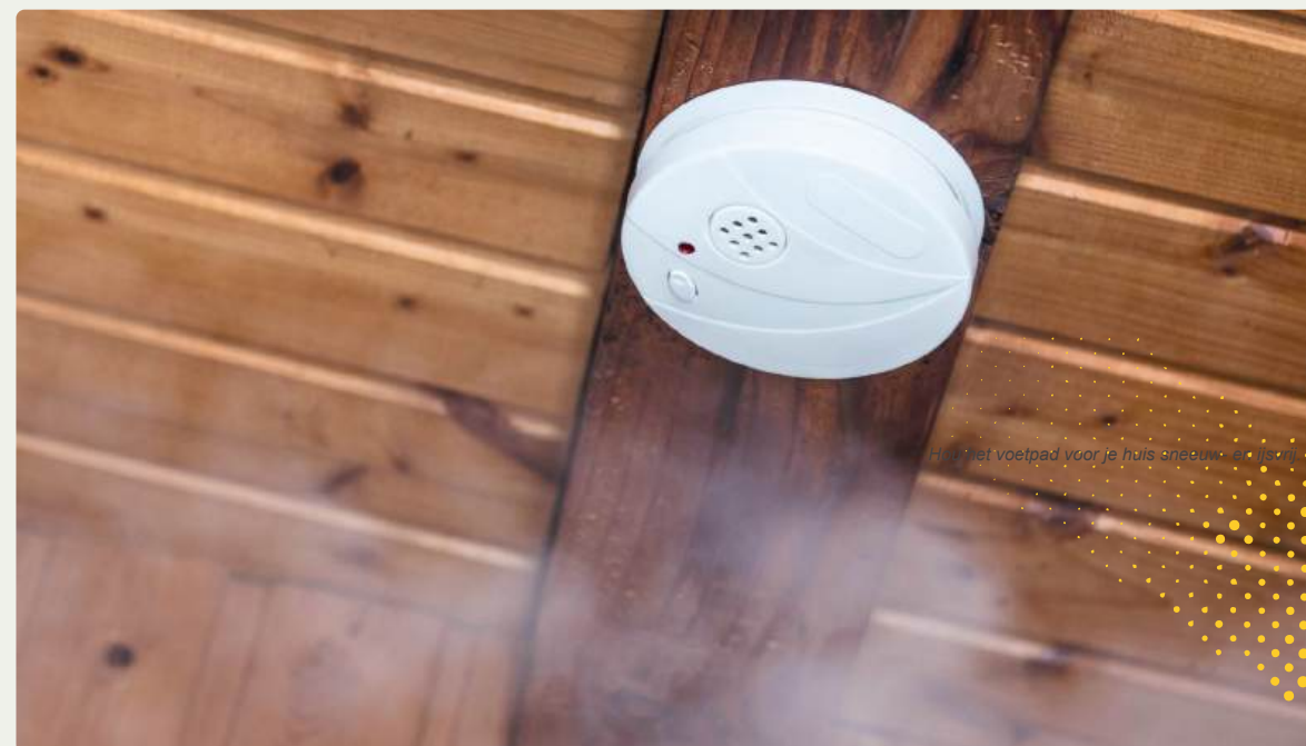
Een rookmelder is verplicht op elke bouwlaag van je woning.
